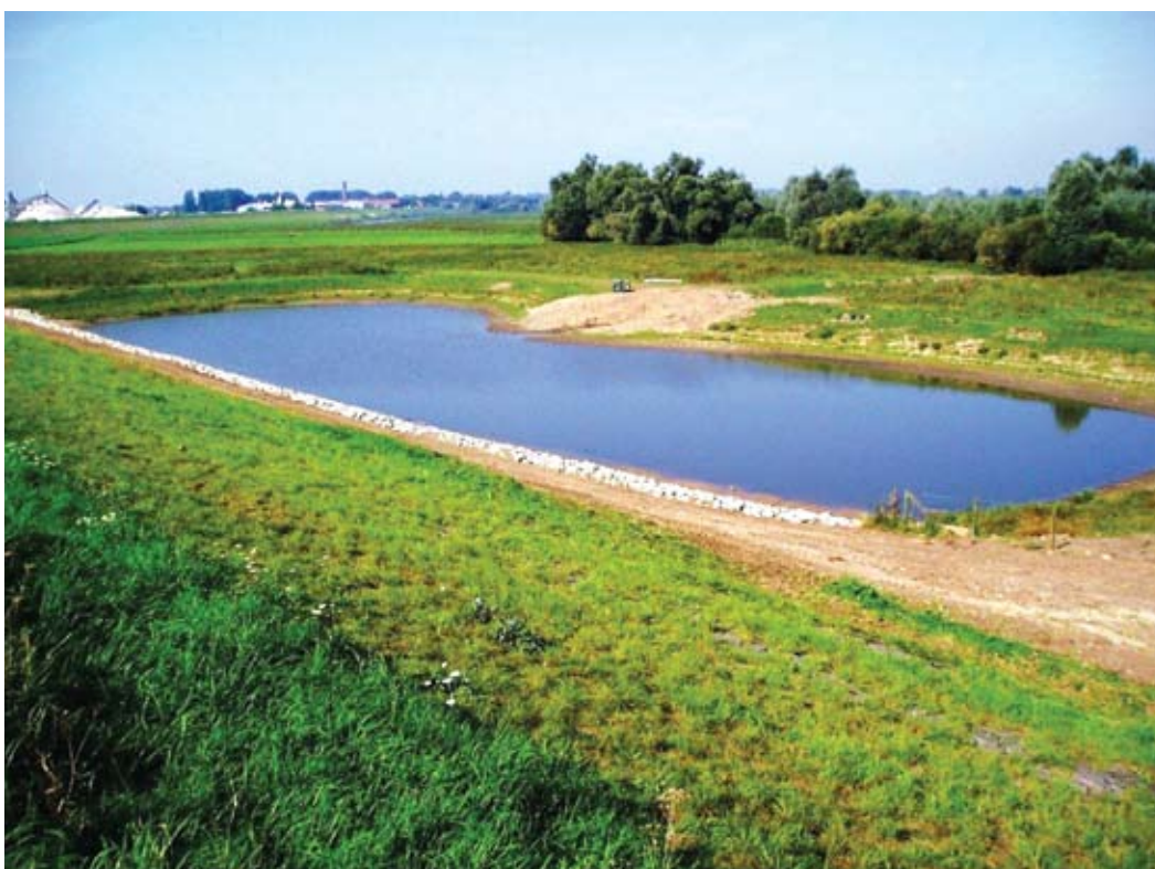
Versterkte oever langs de Erlecomse Dam na graverij door bevers.
