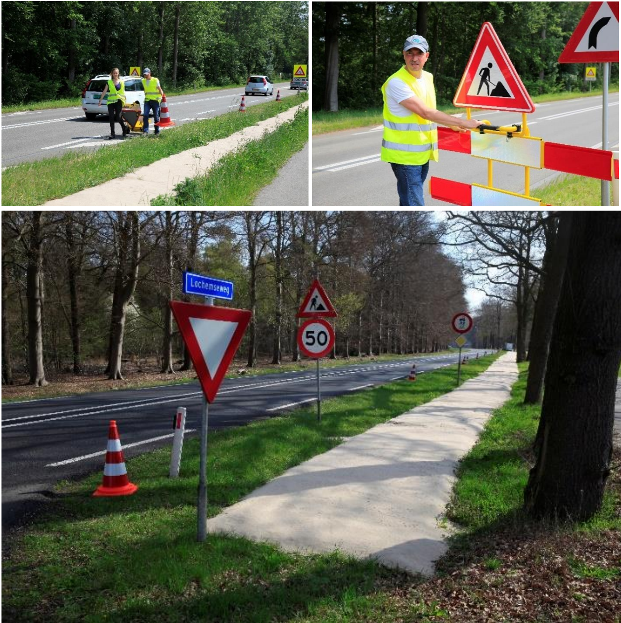
Figuur 2.12 Voor het inventariseren van sporenbedden vlak bij het wegdek is de werkplek eerst afgezet met pylonen (linksboven), zijn borden 'werk in uitvoering' geplaatst (rechtsboven) en is de toegestane maximale rijnsnelheid op het gehele traject van 3 km teruggebracht naar 50 km/uur (onder).
